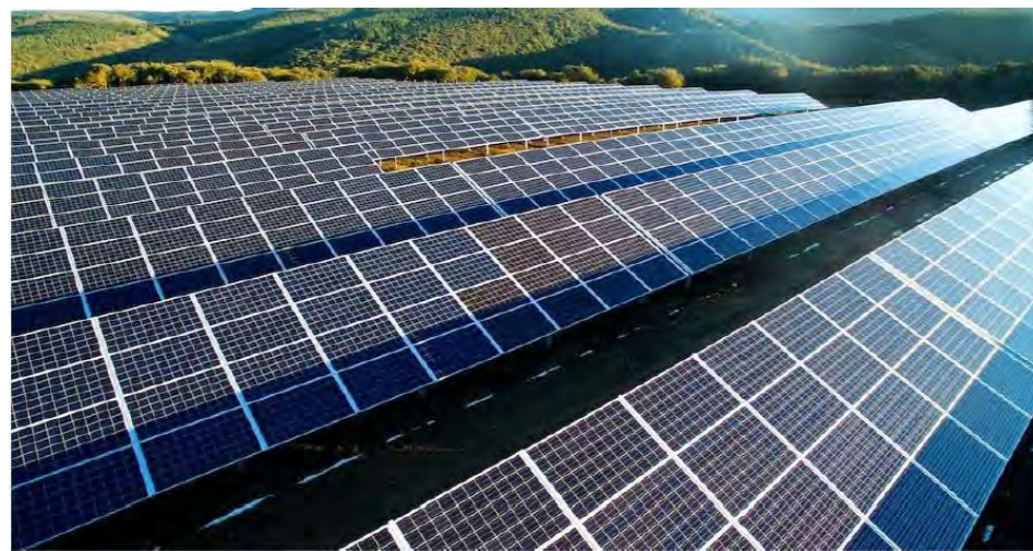
Figure 18 : Exemple de structure fixe (Source : RES)
