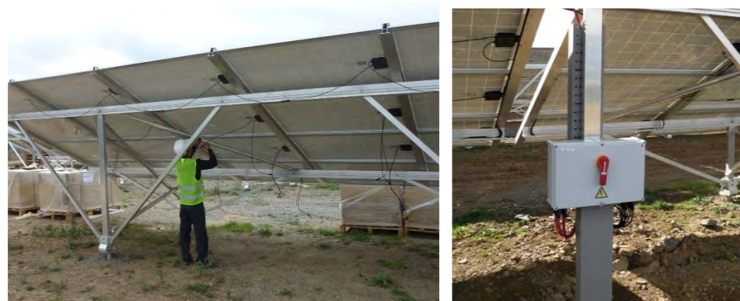
Figure 35 : A gauche : Câblage des panneaux – A droite : Boîtier de raccordement (Source : RES)
