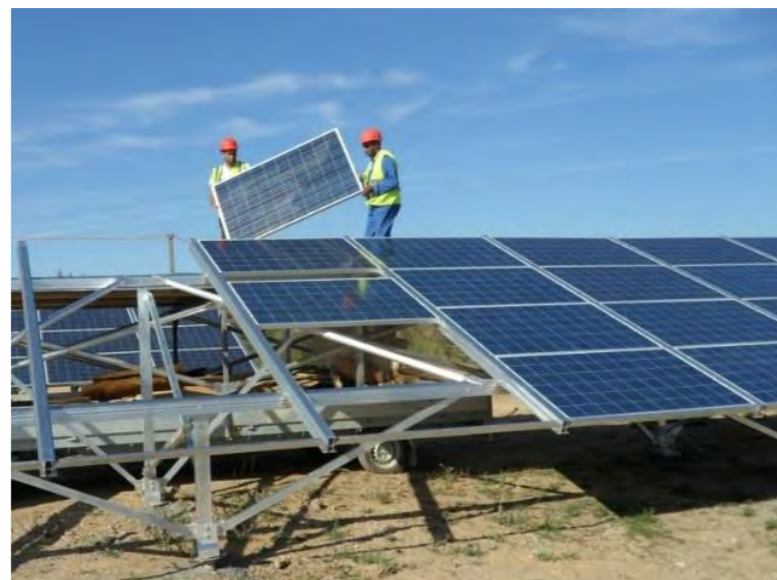
Figure 32 : Exemple de mise en place des panneaux sur les structures (Source : RES)
